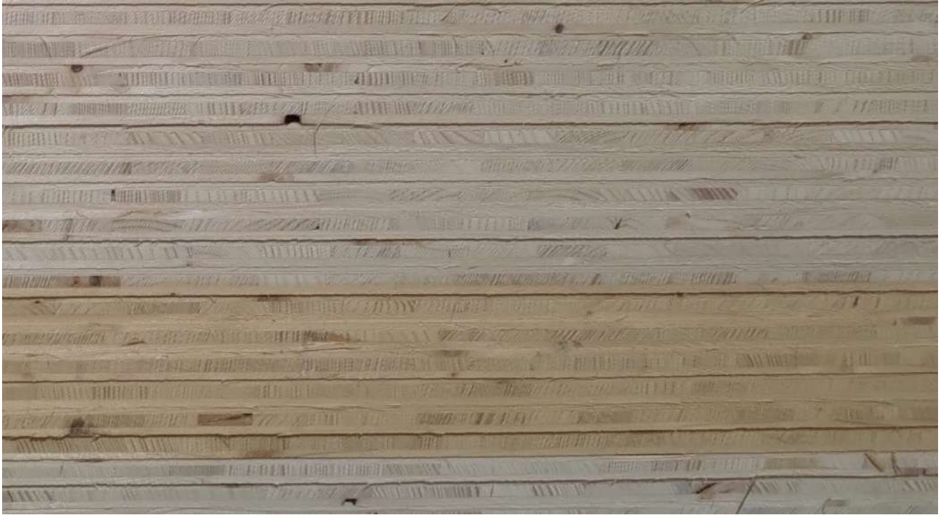
I pannelli in legno trestrati che serviranno per chiudere i cassoni e garantire la resistenza al sisma
